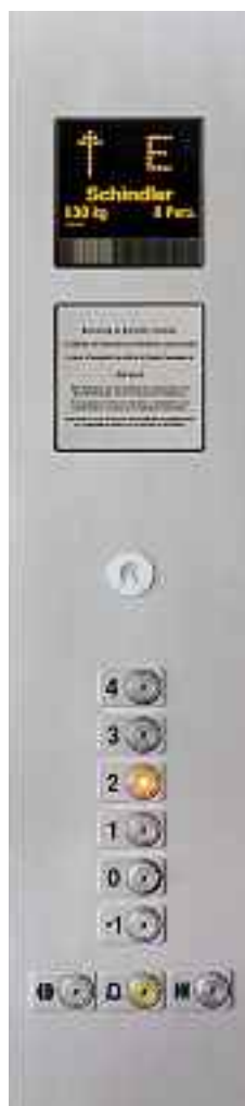
Painel de comando da cabina
