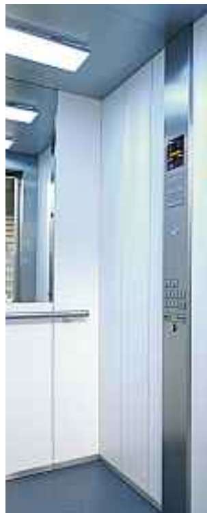
Painéis: Termolaminado, Branco Aveludado Pavimento: Sintético escuro com efeito "celeste" Tecto: Aço inox escovado
