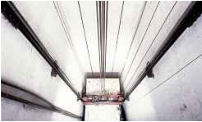
Caixa do elevador
