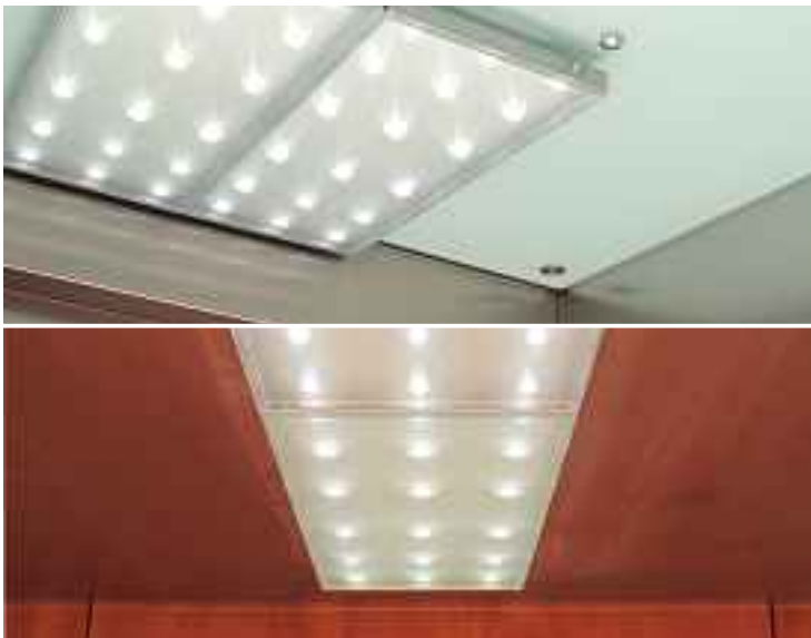
Tecto com iluminação
